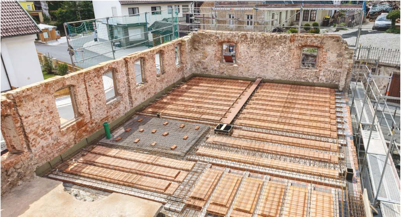
Kernsanierung einer ehemaligen Gaststätte in Lorenzreuth. Die Decke ist inklusive aller Bewehrungselemente komplett verlegt und damit bereit für das Einbringen des Vergussbetons.
